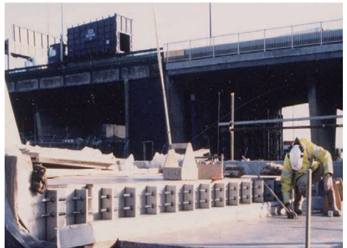
ダートフォード・リバー・クロッシングでは凍結防止塩の腐食作用に対しステンレス デッキ・ジョイントが設置された。
