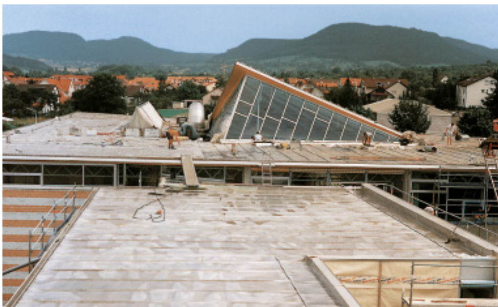
La toiture en inox soudé avant d'être plantée (ci-contre) et après (page suivante)
