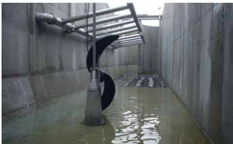
Szczegół z instalacji w oczyszczalni ścieków Zdjęcie: Regeneracija, Lesce (SI)
