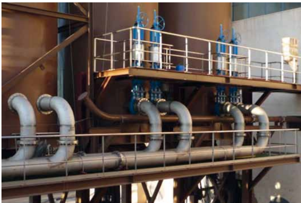
Dopływ odwadniania mułu do silosa magazynowego Zdjęcie: Cedinox, Madryt (E)
