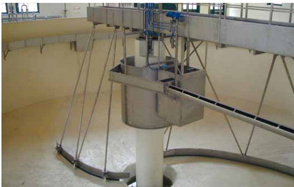
Całkowicie zadaszona oczyszczalnia w Vallarsa (1) Zdjęcie: Centro Inox, Mediolan (1)
