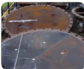
Nuance 1.4003/410, Columbus, Afrique du Sud. L'acier au carbone (en haut) comparé au ferritique (en bas) après 6 ans de service.
