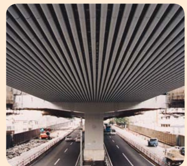
Schallabsorbierende Brückenverkleidung, Japan.
