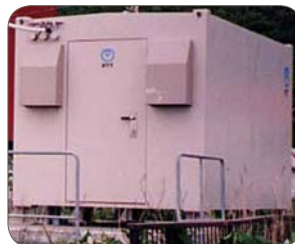
通信システム施設
