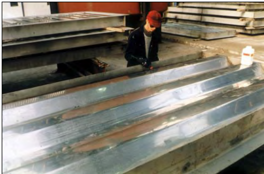
Fabbricazione di una parete trapezoidale resistente agli scoppi per i lati superiori di una piattaforma offshore
