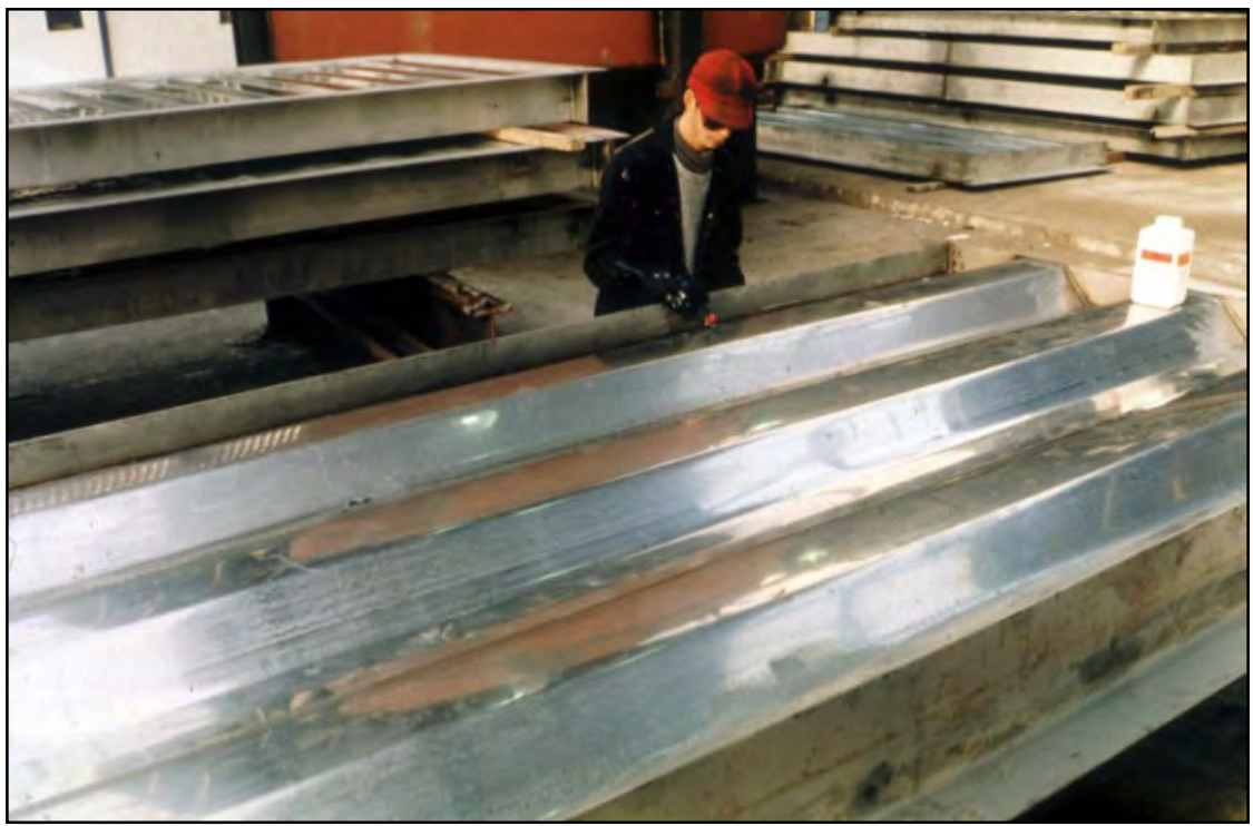
海上プラットフォームの甲板に建設中の 台形耐衝撃壁
