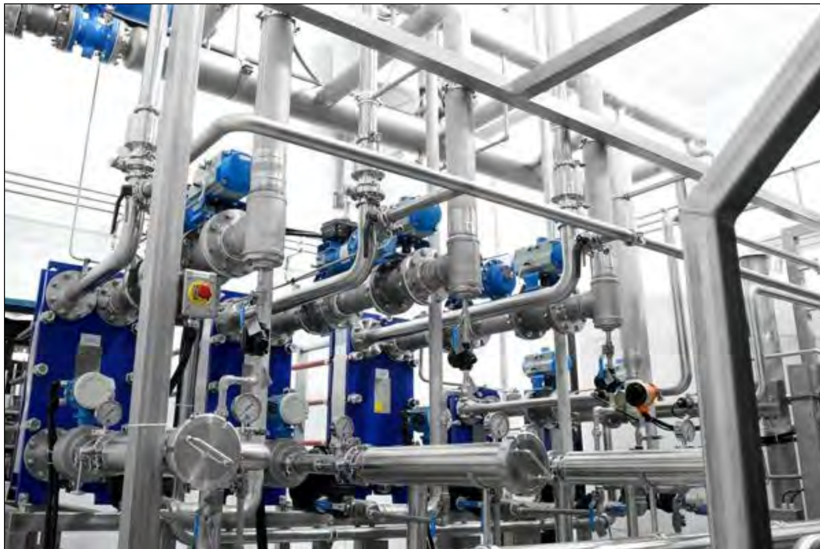
Instalacja rurowa ze stali nierdzewnej
